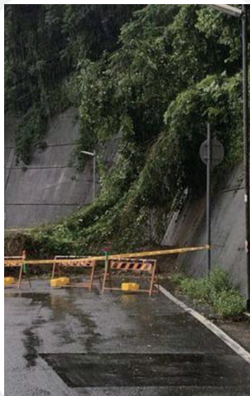
塩屋多井畑線の土砂崩れ
